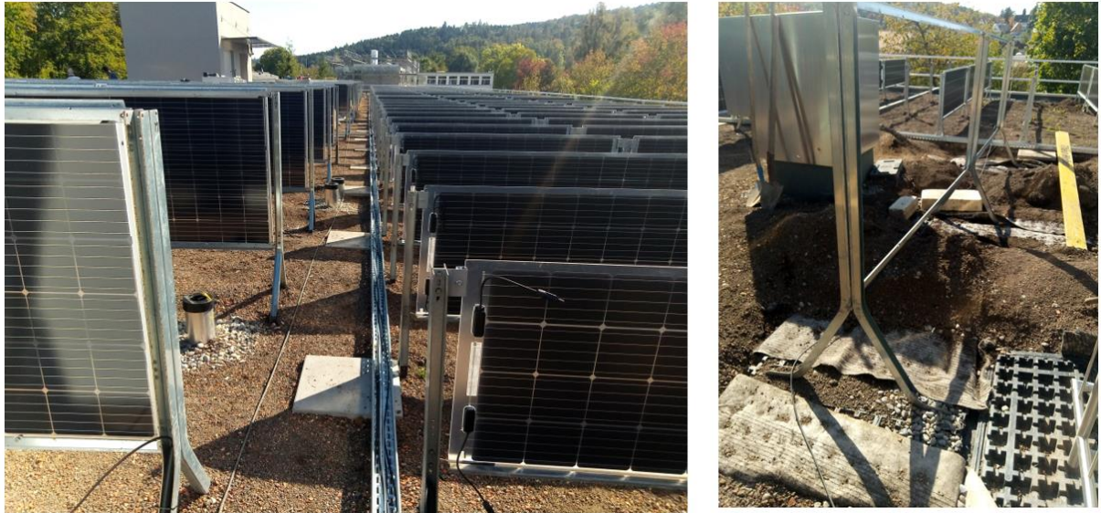
Abbildung 20: Die grossen bifazialen Module mit 72 Zellen haben sowohl einen umlaufenden Rahmen an jedem Modul wie auch einen zusätzlichen Rahmen der Unterkonstruktion (rechte Abbildung), der bei den grossen Modulen zu zusätzlicher Verschattung an der Oberseite führt. Bei den schmaleren Modulen mit 48 Zellen fehlen diese Abschattungselemente an der Oberseite.
