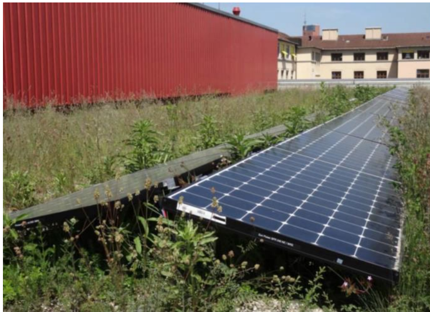
Abbildung 1: Der Bewuchs auf Gründächern kann zu einer offensichtlich nachteiligen Abschattung der PV-Anlage führen. Wartungsarbeiten werden wiederum durch eine dichte Belegung mit PV-Modulen erschwert.
